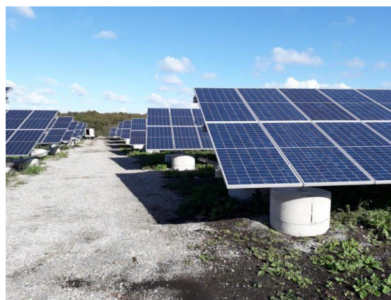
Ferme solaire de Crozon
