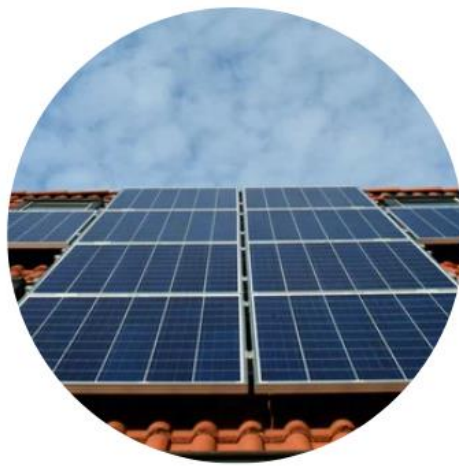
Solaire photovoltaïque ou thermique en toiture
